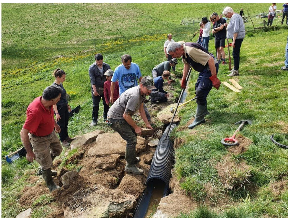
Renforcement d'un passage automobile par-dessus une rigole au Sarrat de Gaye Chantier organisé par l'Association des Rigoles de Gaye : © OAPHB 2022
